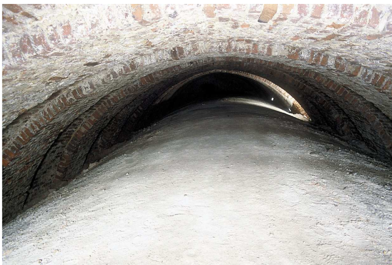
Ryc. 6. Strop jednego z pomieszczeń. Tu najlepiej widać technikę budowy tzw. przestrzeni technologicznej. Fot. D. Wójcik i K. Krzyżanowski
